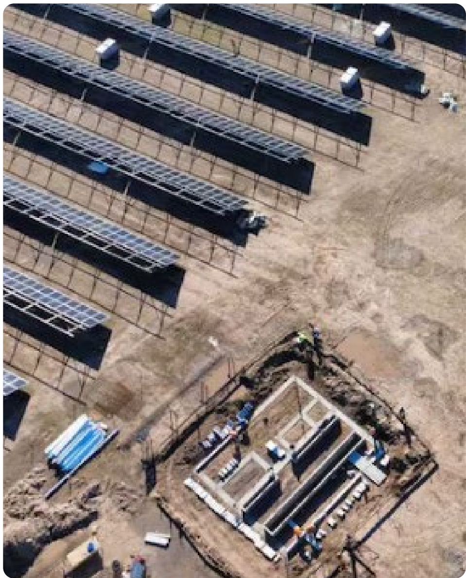
Parque Solar Fotovoltaico - Arroyo Cabral
